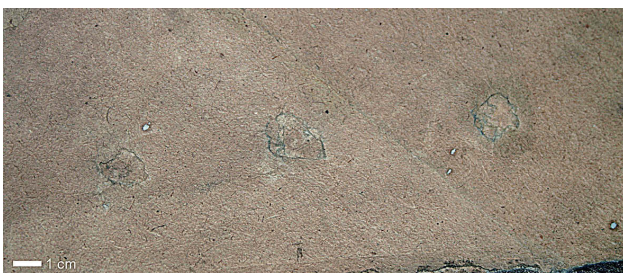
Abb. 355: Detail aus dem Karton „Maria Theresia“: mit Papier überklebte Löcher; Nö. Landesmuseum, Inv. Nr. 769.
