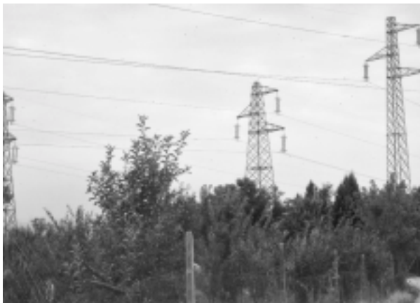
La formazione di più elettrodotti in fascio determina, in particolare per la rilevante moltiplicazione dei tralicci, una decisa amplificazione degli effetti sul paesaggio.
