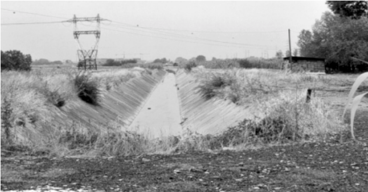
Figura 26 - Un canale collettore della piana di Castello con l'alveo murato in calcestruzzo (fotografia di Gabriele Paolinelli, 2001).
