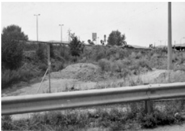
I sistemi di svincolo e raccordo con la viabilità locale danno luogo a spazi pertinenziali inutilizzati che generalmente risultano in condizioni di degrado.
