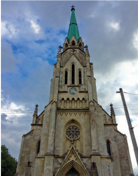
Abbildung 57 – Außenansicht der baufälligen Herz-Jesu-Kirche.
