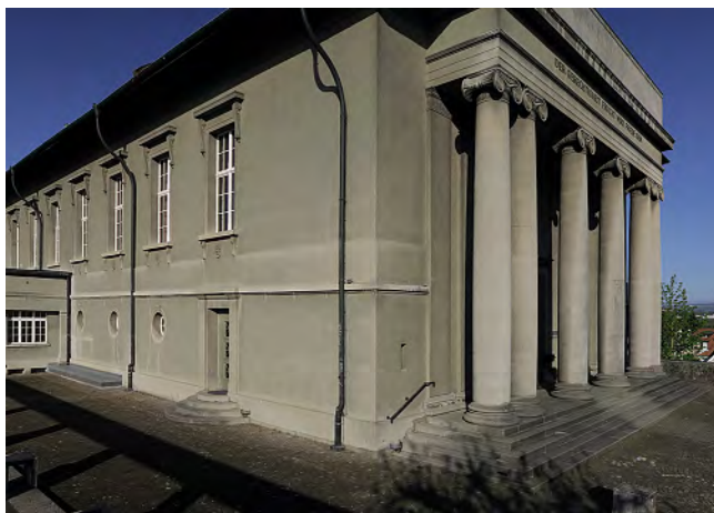
Abb. 274: Bern, Friedenskirche. Detail des Äusseren mit dem Edelputz «Jurasit», der einerseits den Berner Sandstein imitiert, andererseits dem Gebäude eine ruhige Flächigkeit verleiht und diese durch glitzernde Glimmereinschlüsse aufwertet. – Autor, 2020.
