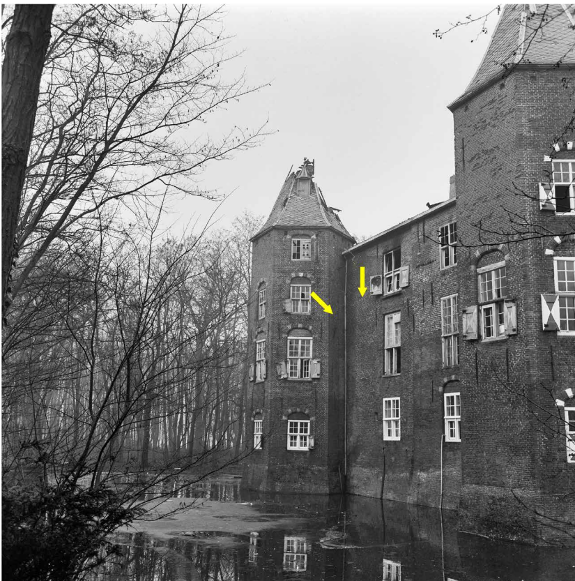
Afb. 93. De zuidgevel na de brand. Ook hier is goed het wat lichter gekleurde inboetwerk aan de bovenzijde van de gevel rond beide linker verdiepingvensters herkenbaar. De daklijn van de eerdere galerij is hier zeer duidelijk herkenbaar (pijlen). RCE, nr. 135.764 (G.J. Dukker).
