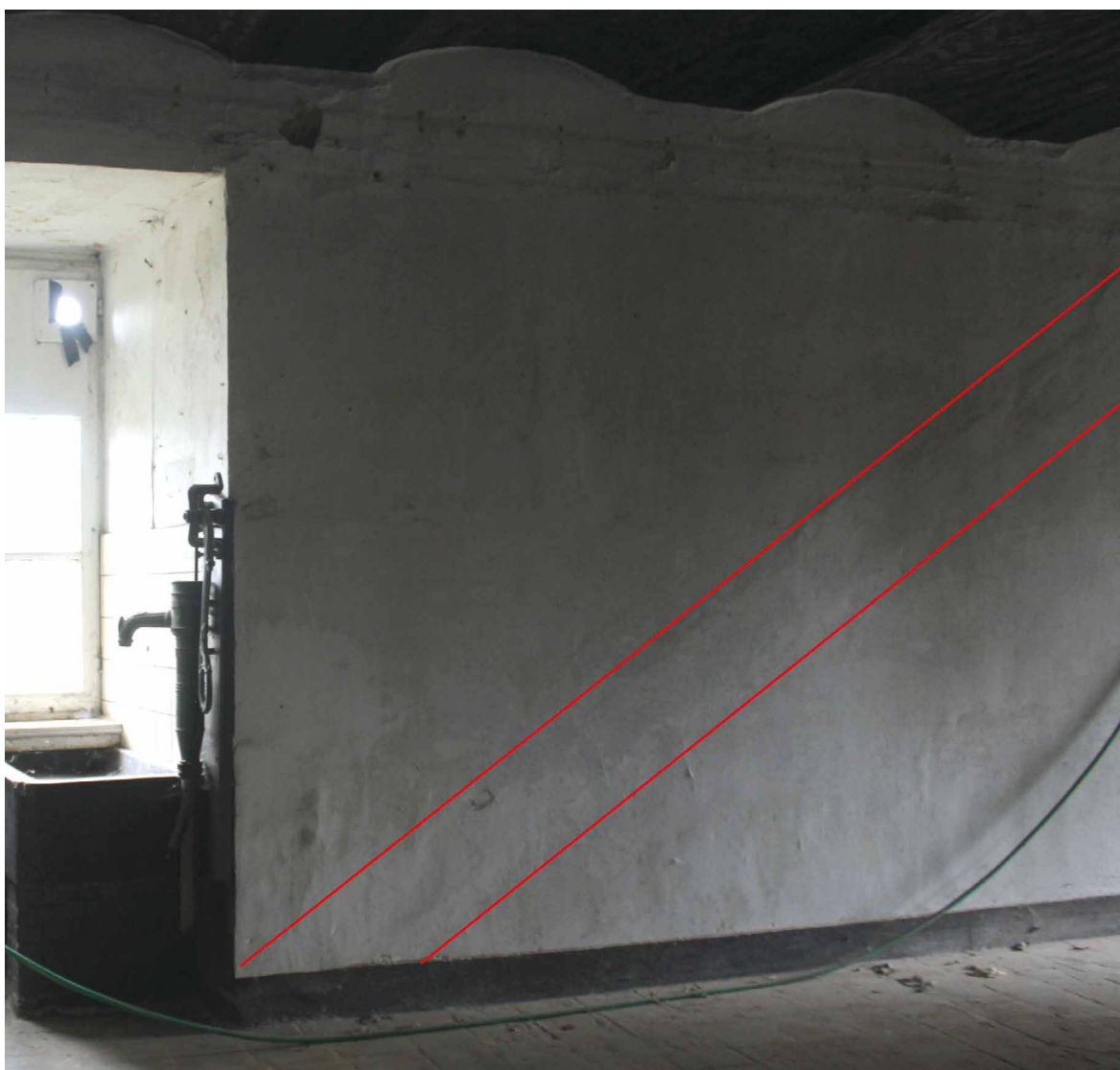
Afb. 36. De zijgevel van de keuken (ruimte -1.8, zie afbeelding 35) met binnen de rode lijnen sporen van een trap naar de beletage. De kamer is recent opnieuw afgewerkt waardoor deze laag niet meer zichtbaar is. Foto auteur 2020.
