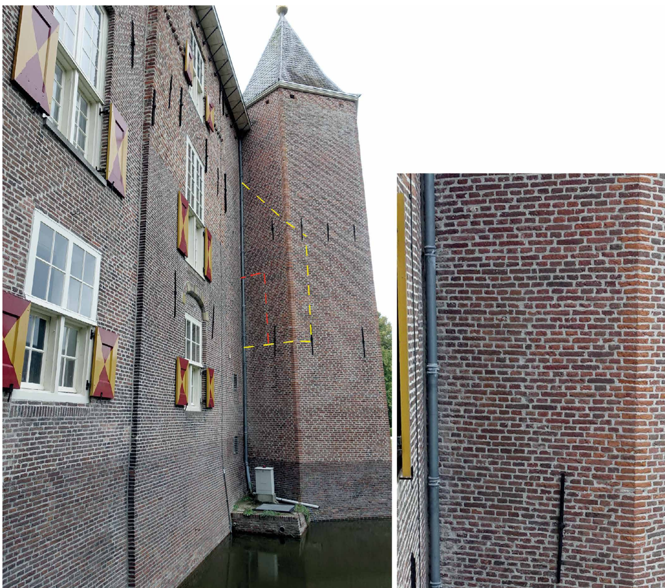
Afb. 49. Zicht langs de zuidgevel op de zuidoostelijke toren. Binnen de rode contour tekent zich de met iets donkerder steen dichtgemetselde toegang tot de galerij af. Bij de zuidwestelijke toren is de voormalige opening uitsluitend herkenbaar aan het soms wat slordige metselverband. Rechts een detail van de aan de iets donkerder kleur herkenbare dichtgemetselde deuropening in de torengewel. Foto auteur.
