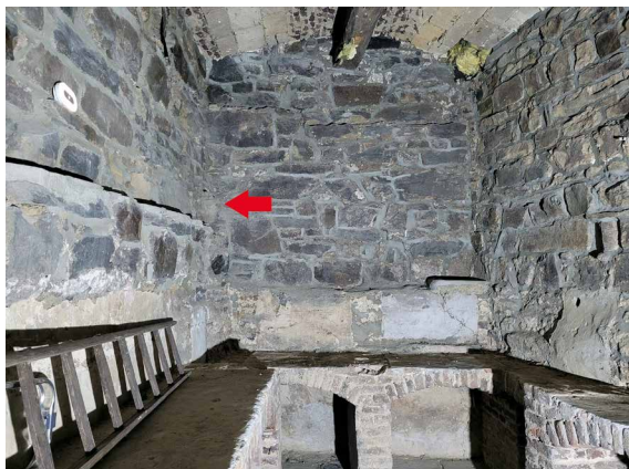
Afb. 31. De vulmuur in ruimte -1.4 met bij de pijl de koude naad. Foto auteur 2024.
