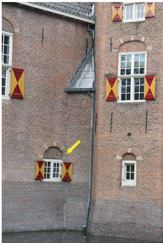
Afb. 31. Aansluiting van de noordwestelijke hoektoren met bijbehorend privaat op de noordgevel. De gevel van het privaat sluit voor de korfboog aan op de noordgevel (pijl). Foto auteur.
