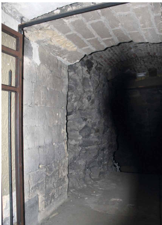
Afb. 32. De doorbraak in de westmuur van de woontoren om ruimte -1.4 toegankelijk te maken. Vooraan het mergel muurwerk van de mergelwestmuur in de woontoren, daarachter het kolenzandsteen van de woontoren. Foto auteur 2024.
