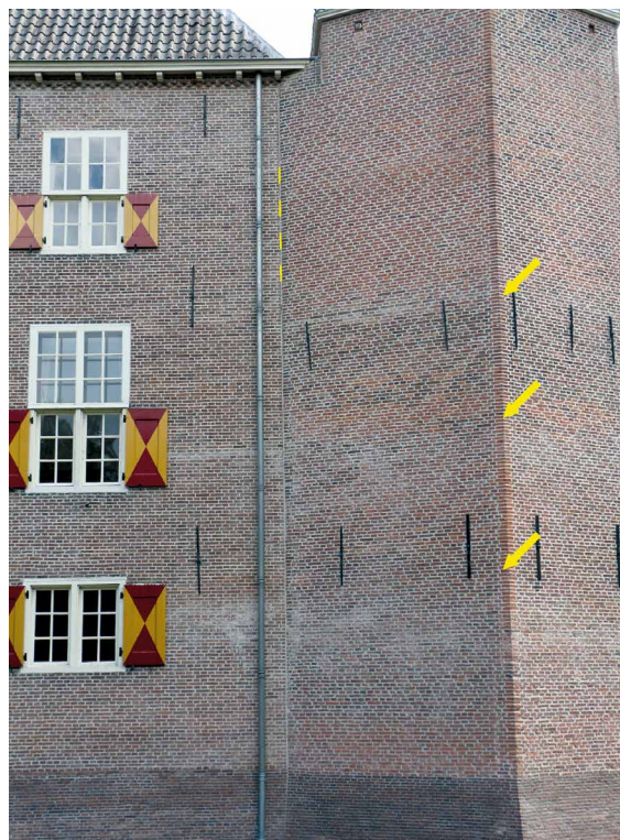
Afb. 58. Westzijde van de zuidwestelijke hoektoren. Hier zijn bij de pijlen duidelijke fasen in de opbouw van het metselwerk herkenbaar. Bij de gele stippellijn is rechts van de verder slordige koude aansluiting een nette dagkant van donkerder steen toegepast. Mogelijk slot de torengevel hier in een eerdere fase aan op de dagkant van een venster. Foto auteur.
