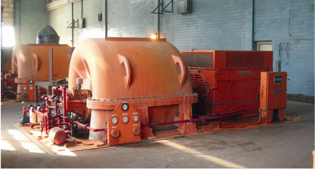
شكل ٩-١٣ نافخ طارد مركزي متعدد المراحل بريشات توجيه متغير في حالة تشغيل في محطة مياه صرف صحي كبيرة، وتظهر الأبعاد الكبيرة للنافخ، وهي التي تسحب ٣٥٠٠ ك. واط و ٤١٦٠ فولت أمبير تيار وناتج حوالي ٢٦ نيوتن متر مكعب/ ثانية (١٦٠٠ نيوتن متر مكعب/ دقيقة) في أمثل وضع تشغيل ( photos: (D. Rosso)
