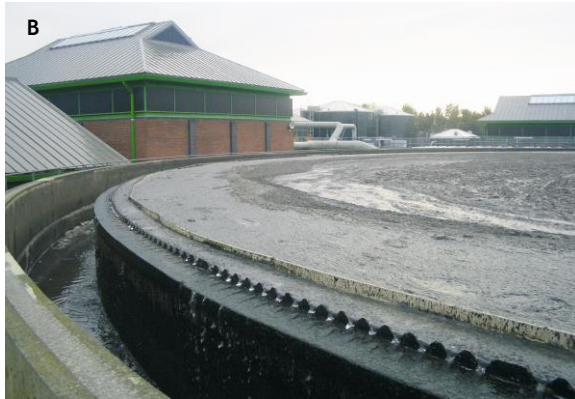
شكل ١١-٣ كابوس مشغلي محطة معالجة مياه الصرف الصحي (أ) الحمأة الخيطية (ب) الحمأة المنتفخة، خارجة من المحطة مع المياه الخارجة (photos: D.H. Eikelboom and D. Brdjanovic)
