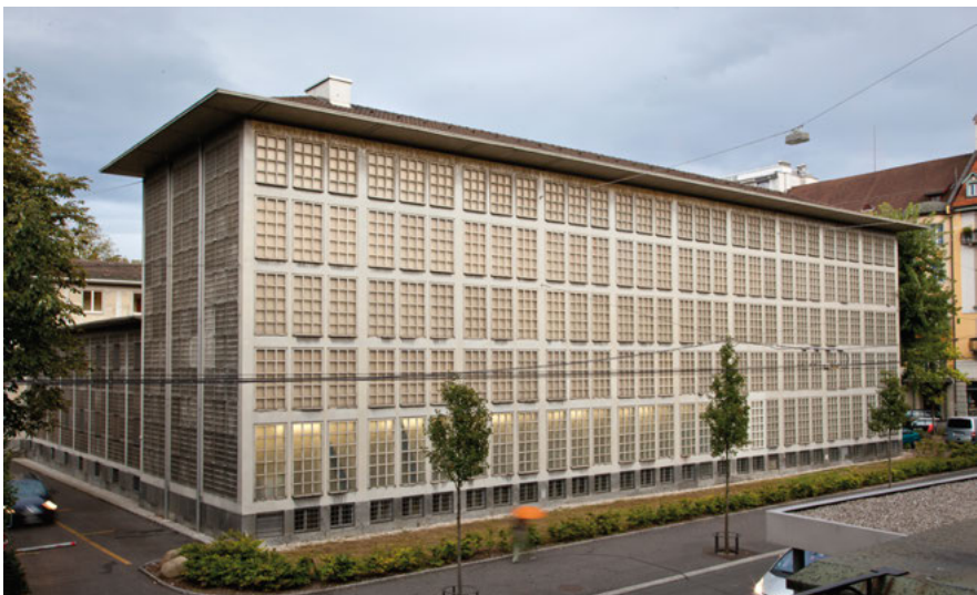
Abb. 3: ZHB, Magazin an der Hirschmattstrasse. Die teils schadhaften, abgebrochenen Simsse sind deutlich sichtbar. (© Ulrich Niederer, ZHB Luzern)
