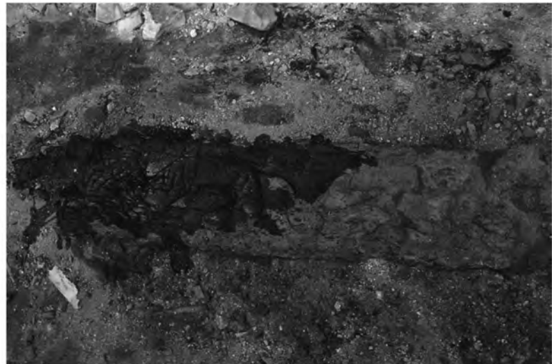
Abb. 35: Marmorsaal 31, verkohlter geschnitzter Balken
