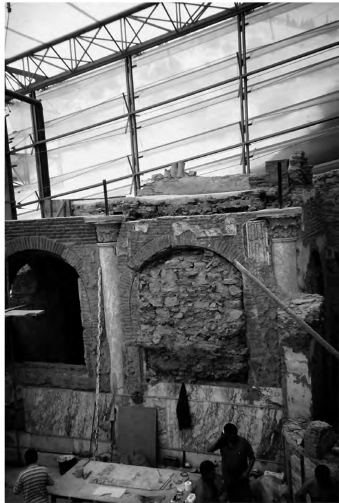
Abb. 7: Peristylhof 31a mit dem nach der Zerstörung zugemauerten Fenster des Bades 31aO/M2
