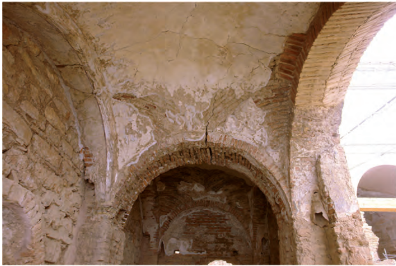
Abb. 12: Raum 31aO.M1, Rest der Stuckverzierung der Decke
