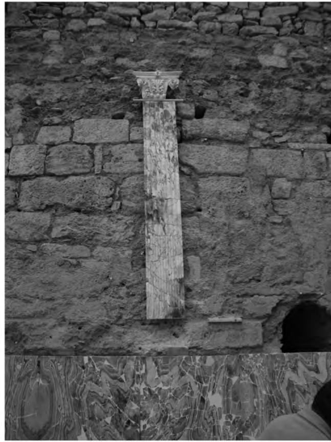
Abb. 13: Marmorsaal 31 O-Mauer, Hinterfüllmörtel der Vertäfelung
