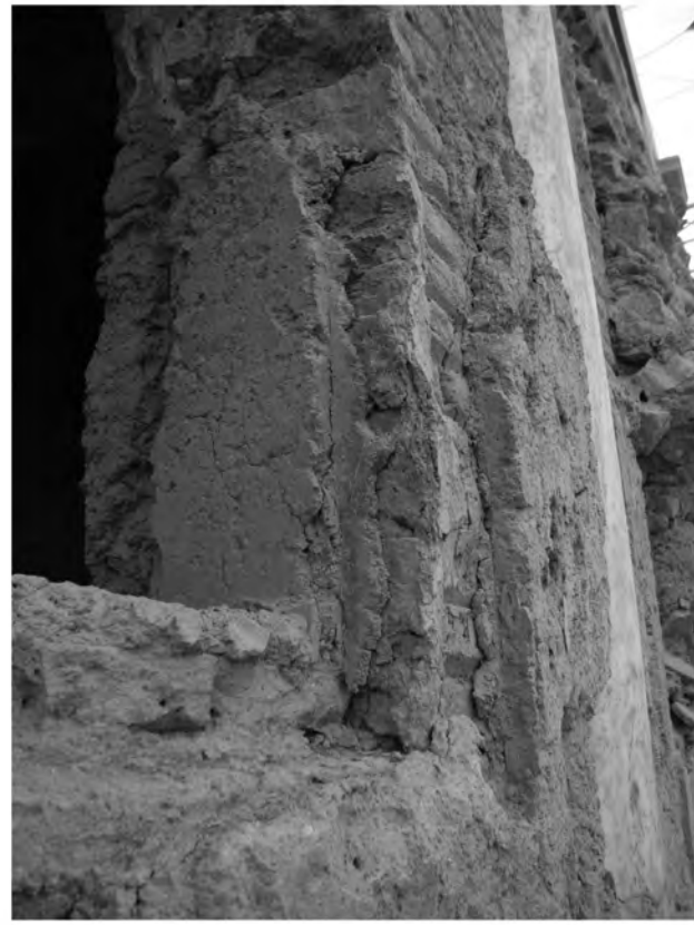
Abb. 72: Fenster im Peristylhof 31aO zum Raum 31aO/M1, Abdruck des Holzrahmens an der S-Seite
