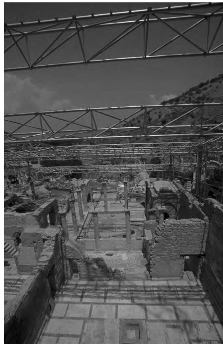
Abb. 40: Blick in den Marmorsaal 31 und den Peristylhof 31a im Jahr 2000 während des Baus der neuen Schutzdachkonstruktion
