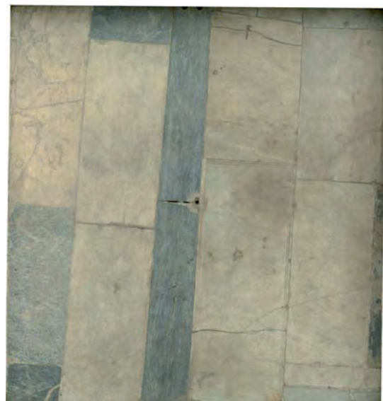
Abb. 7: Verteilerraum 36, Bodenbelag im Becken
