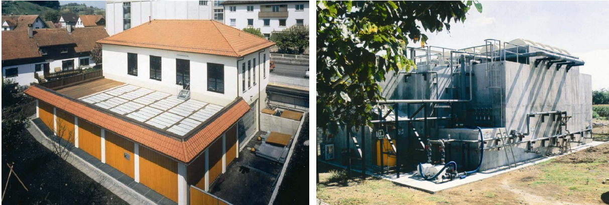
Figura 16.18 Instalaciones de UASB para el tratamiento de (A) agua residual proveniente de una fábrica de jugo de frutas en Bregenz, Alemania y (B) agua residual de una industria de lácteos en Indonesia (Imágenes: Paques B.V. y Biothane B.V. respectivamente)
