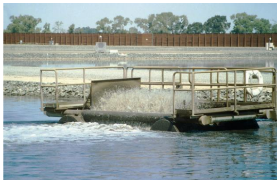
Figura 9.5 Mezclador superficial de cepillo montado sobre un elemento flotante dentro de una laguna de aireación (foto: M.K. Stenstrom)
