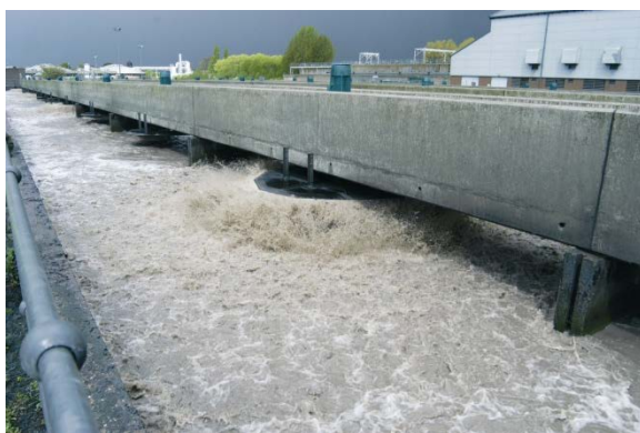
Figura 3.4 La aireación superficial en una planta de lodos activados genera aerosoles con una alta concentración de microorganismos. Esto representa un riesgo para la salud de los empleados de la planta de tratamiento y en algunos casos para los vecinos. (Foto: D. Brdjanovic)
