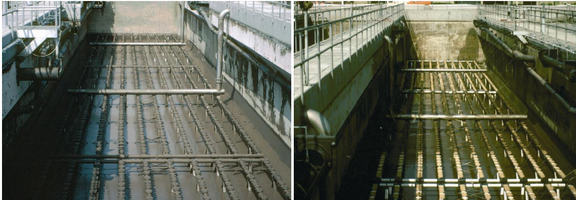
Figura 9.21 Tanque de aireación vacío equipado con domos cerámicos antes (izquierda) y durante (derecha) la limpieza con manguera desde lo alto el tanque. Los difusores con un color más claro que se puede observar en la parte baja de la figura de la derecha han sido limpiados (fotos: M.K. Stenstrom)
