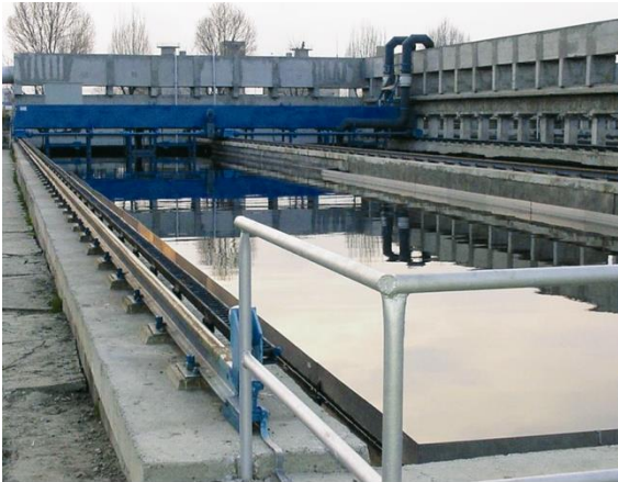
Figura 12.4 Clarificador rectangular (foto: D. Brdjanovic)
