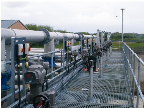
Figura 15.15 Detalle de la medición y el control del tanque de aireación en un sistema de lodos activados (foto: D. Brdjanovic)
