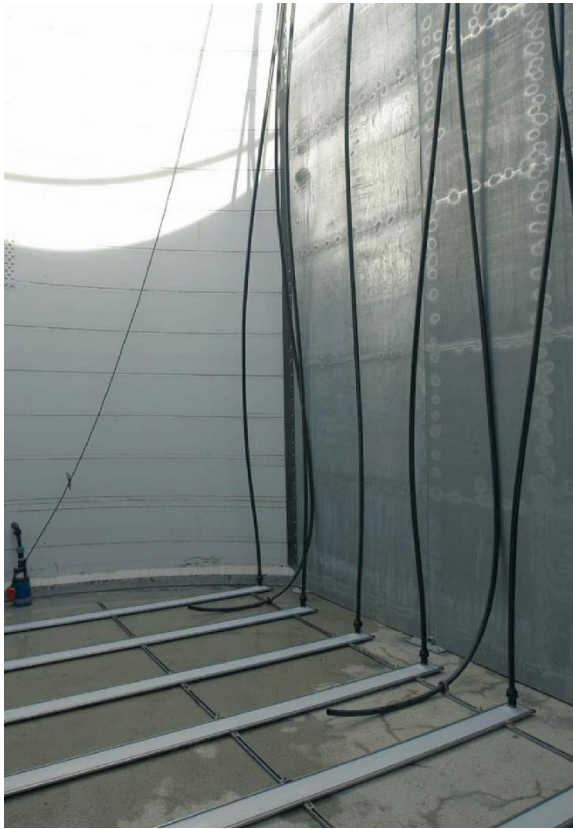
Figura 9.26 Difusores de poro fino (en este caso paneles de membrana) ubicados dentro de un tanque de 5 m de profundidad antes de llevar a cabo las pruebas en agua limpia (foto: M.K. Stenstrom)
