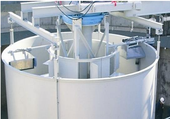
Figura 12.7 Pozo de floculación (foto: Brown y Caldwell)
