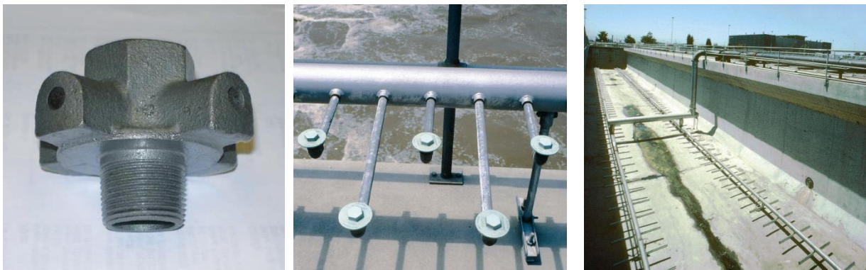
Figura 9.6 Rociadores de aire (izquierda) instalados en el fondo del tanque de un reactor de lodos activados (centro). A la derecha se muestra en detalle la instalación de los rociadores, espaciados alternadamente a una distancia más corta o más larga con respecto al tubo de suministro de aire principal con la finalidad de incrementar la distribución de aire (fotos: M.K. Stenstrom)
