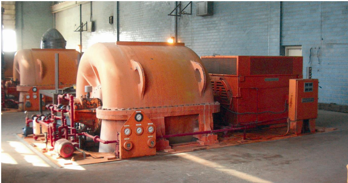
Figura 9.13 Sopladores centrífugos de múltiples etapas con conductos de succión variables instalados en una planta de tratamiento de aguas residuales de gran capacidad. La línea de referencia ilustra las grandes dimensiones del soplador, con una capacidad de consumo de 3500 kW, 4160VAC y salidas de aproximadamente 26 \text{ Nm}^3/\text{s} ( \sim 1600 \text{ Nm}^3/\text{min} ) bajo condiciones óptimas de operación (foto: D. Rosso)
