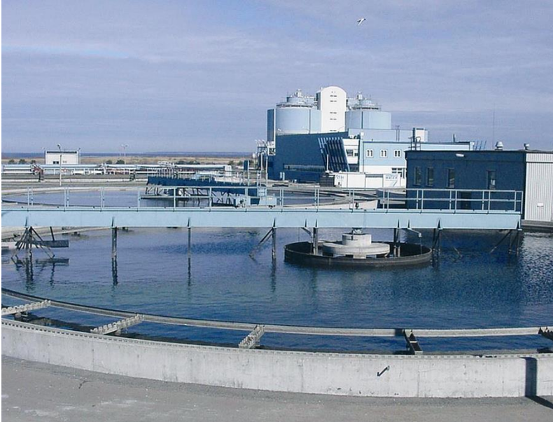
Planta moderna de tratamiento de aguas residuales diseñada para eliminar materia orgánica (DQO), nitrógeno (N) y fósforo (P), localizada en la ciudad de Tallin, Estonia (foto: D. Brdjanovic)
