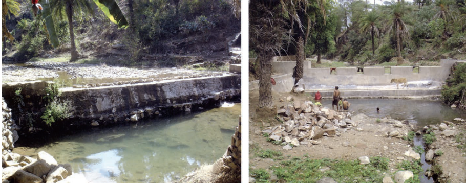
Figure 32. Rénovation de la structure de collecte des eaux « Bhutiya » dans le village de Amda, avant et après l'intervention
