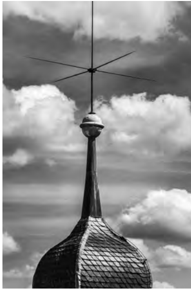
Abb. 4. Einer der heute noch zu sehenden Blitzableiter Hemmer'scher Bauart auf dem Schwetzingen Schloss (Foto: Horst Hamann)
