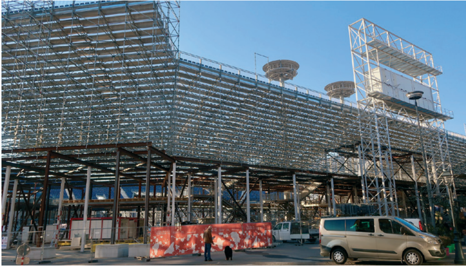
Figure 52 Construction de la structure du tablier, de la structure tubulaire, des gradins et des mâts de régie et de son, 20 mars 2019. © Dominique Vinck
