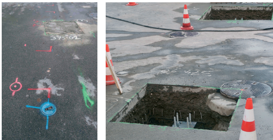
Figure 48 Marquages au sol et implantation d'un pieu de l'arène tenant compte de l'infrastructure industrielle, 30 octobre 2018. © Dominique Vinck
