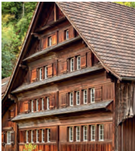
ABB. 24 Sevelen, Dorf. Histengass 72/74. Klebdächer sind nicht typisch für Werdenberg und mit geringen Belegzahlen auf die südlichen Gemeinden Sevelen und Buchs konzentriert. Möglicherweise sind sie auf Toggenburger Handwerker zurückzuführen. Bis auf wenige Beispiele blieben sie holzsichtig oder monochrom. Foto Jürg Zürcher, St. Gallen 2019.
