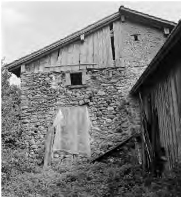
ABB. 438 Sennwald, Sax. Rütigass 24/28. Bergseite mit Fokus auf Nr. 28 links. Die Fotografie gibt Aufschluss zu einigen Etappen der Bauentwicklung von Haus Nr. 28. Baufugen deuten Störungen, Um- und Wiederaufbauten an. Foto Bernhard Anderes, Rapperswil 1974. (KDP SG, Best. 710.0213).
