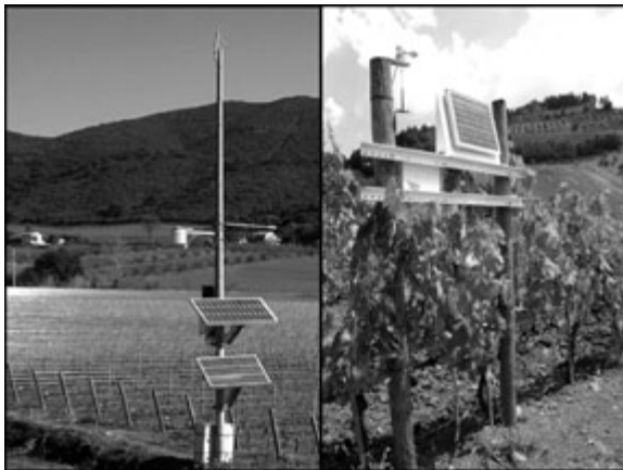
Figura 16. Il sistema NAV installato in campo; stazione master (a sinistra), stazione slave (a destra)
