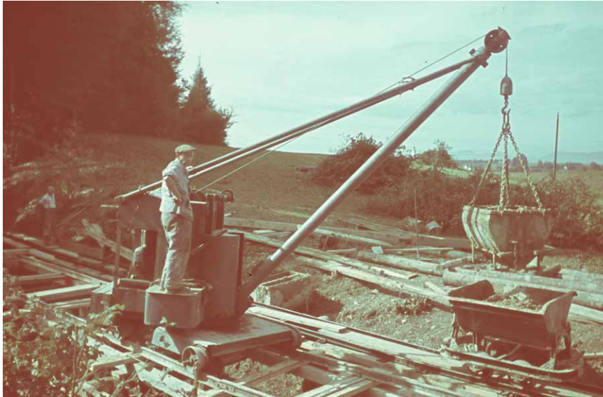
Abb. 3.3: Aeschi SO, Burgäschisee-Nord. Aushub des Seebachkanals als neuen Abfluss für den Burgäschisee. Aufnahme: Ernst Klöti, 1942. Bildnachweis: Zentralbibliothek Solothurn, Diasammlung Ernst Klöti, FS D 3/698.
