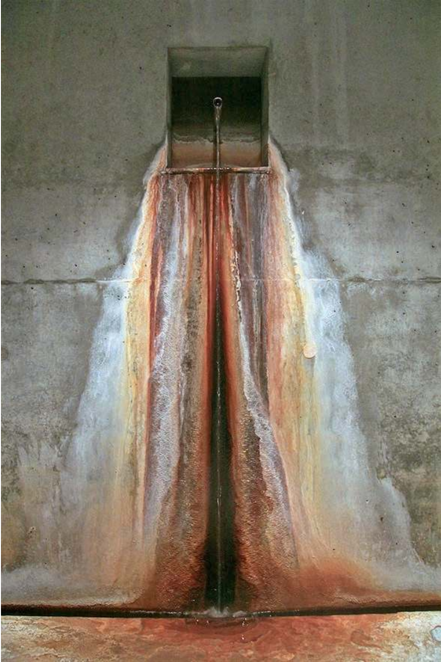
Abb. 5: Therme in Vals, Trinkhalle, Wasserspender mit Ablagerungen.
