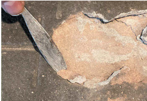
Abb. 70: Loslösung einer Schuppe, 15.2.2021.
