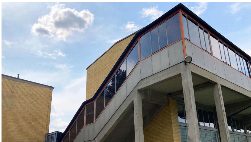
Abb. 7: Laubengang oberhalb der Turnhalle mit Zugang zu den darüber liegenden Seminarräumen (Foto: Wendeburg 2021)
