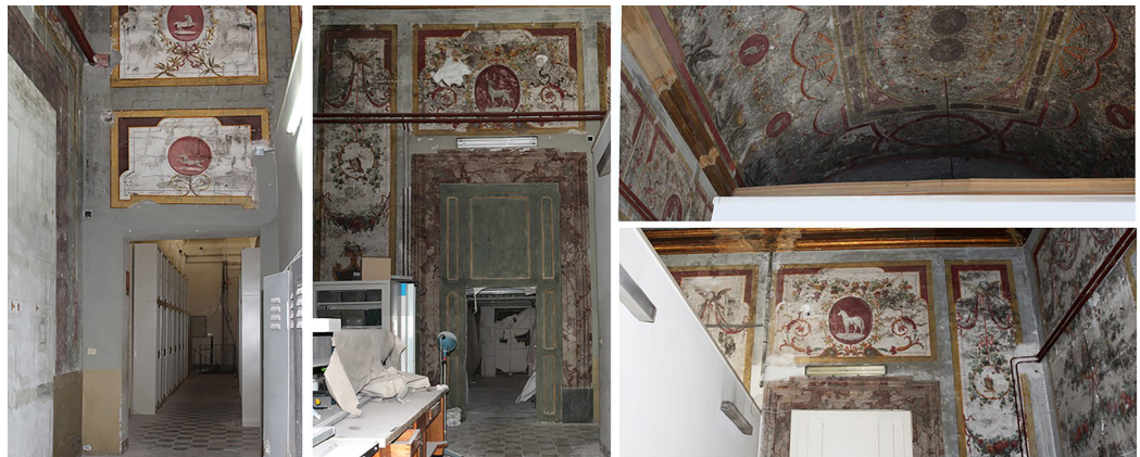
Fig. 4. Vedute interne dello spazio del Teatrino, oggi occupato da superfetazioni utilizzate come archivio, con le decorazioni parietali in un evidente stato di degrado.
