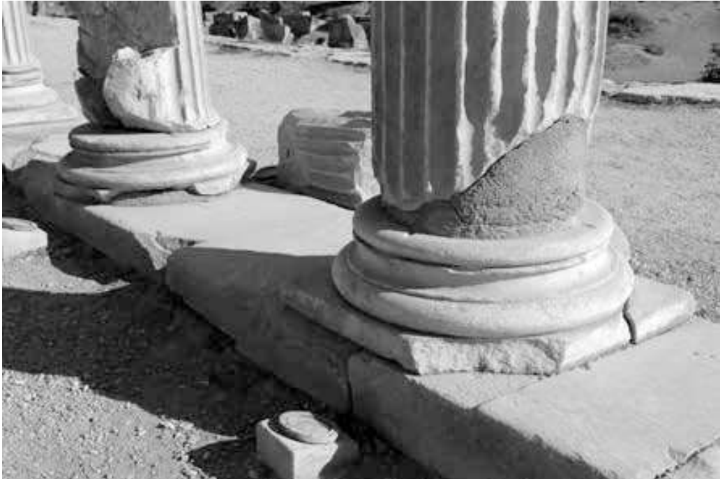
Abb. 4: Aufgrund von Erdbebenschäden (?) eingeschobene Säulenstellungen an der großen Marktbasilika von Ephesos am so genannten Staatsmarkt (Abb. R. Posamentir).
