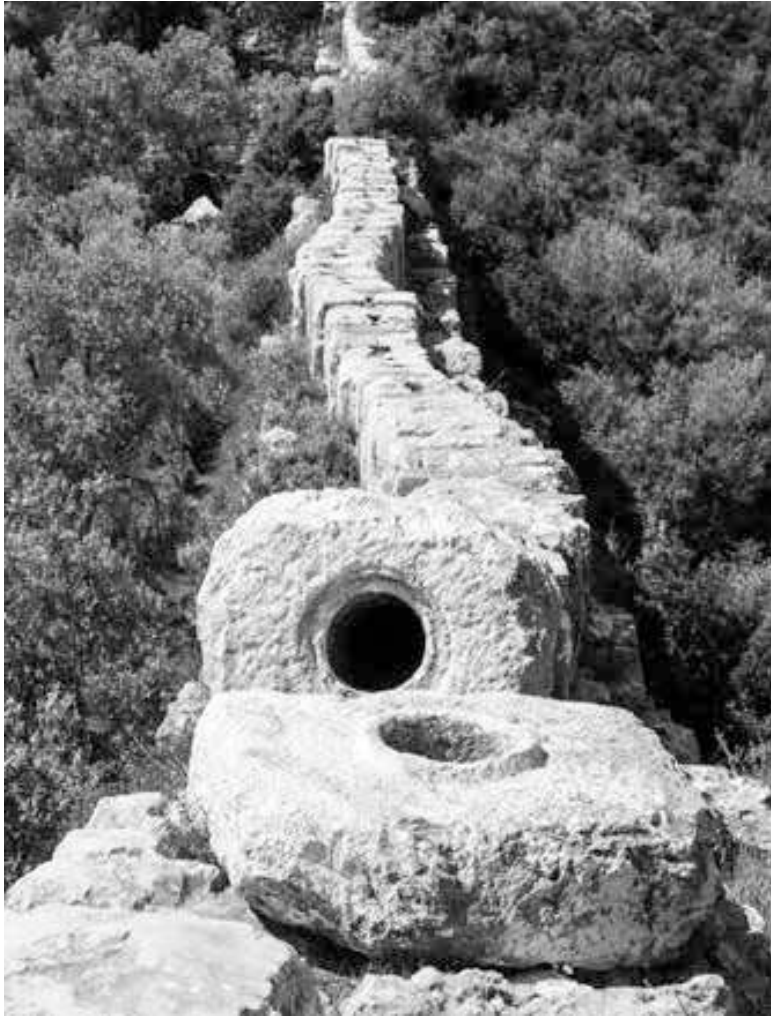
Abb. 3: Auf Erdbebenschäden (?) zurückzuführende Verwerfungen an der Druckrohrwasserleitung von Delikkemer nahe Patara (Abb. mit freundlicher Erlaubnis von R. Rochow, www.histolia.de ).
