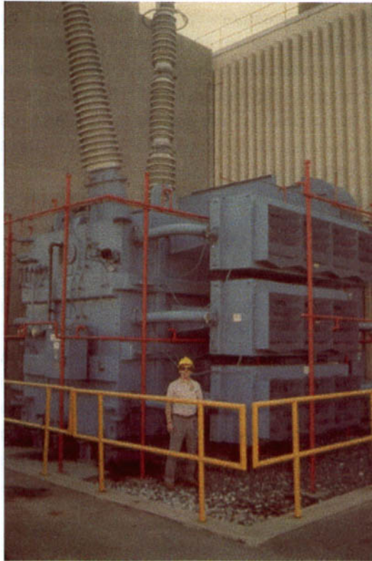
Figure 3.4 - Ce transformateur de la centrale nucléaire de Delaware River, dans le New Jersey, a été endommagé par l'orage magnétique du 13 mars 1989. Il s'agit de l'un des trois grands transformateurs d'une unité totale de 1 200 MVA. Il coûte plus de 10 millions de dollars, et sa réparation peut prendre plus d'un an (crédit Compagnie électrique du Minnesota).
