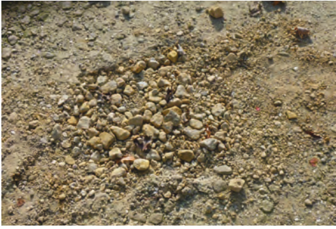
Abb. 5: Schäden an der Wassergebundenen Wegedecke aus Sandsteinquarzit an der Ahne im Süd-Campus des HoPla bestehen bereits spätestens seit 2014 und nehmen zu. Foto vom 29.10.2014.
