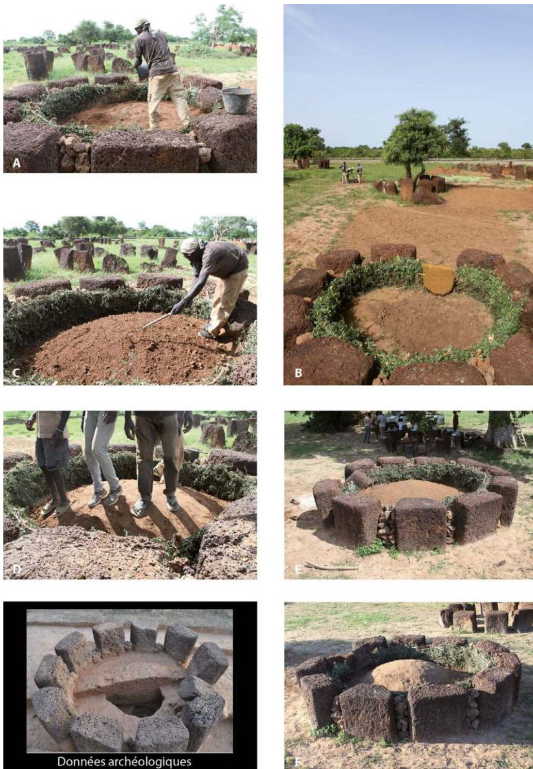
3.3.7 - Fig. 3 : Restauration du monument XIV : construction d'un cône de terre central. A chaque apport successif, les terres sont étalées et damées. La pierre occidentale qui, à cette étape du chantier de construction, n'avait pas encore été basculée sur le dôme de gravillons latéritiques, a été artificiellement masquée sur le cliché B. Clichés L. Laporte.
