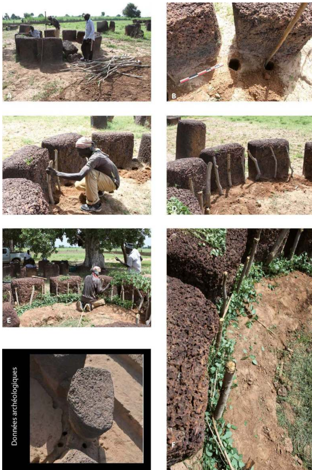
3.3.7 - Fig. 1 : Restauration du monument XIV : mise en place d'un treillis végétal contre la face interne des monolithes du cercle mégalithique. A et B/ Creusement de trous de piquets à intervalles réguliers ; C et D/ Mise en place des piquets structurant la palissade ; E et F/ Mise en place du treillis végétal. Ces opérations ont été réalisées par Mamadou Lamine Cissé, El Hadji Cissé et El Hadji Mbaï. Clichés L. Laporte.
