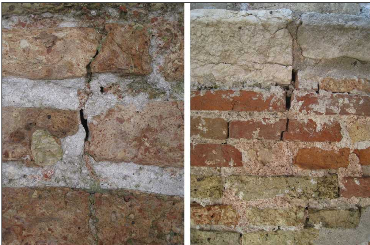
Figura 2. Riparazioni in cocciopesto (rosato) di antiche lesioni riscontrate sul fusto del campanile di Sant'Aponal (foto di F. Doglioni su concessione dell'autore).
