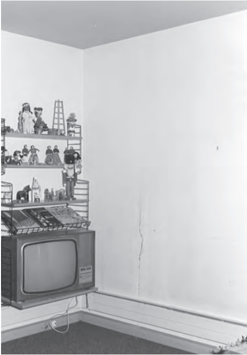
Abb. 4: Vermutlicher Wasserschaden in einem der Zimmer eines „Professorenbungalows“, 1966.
