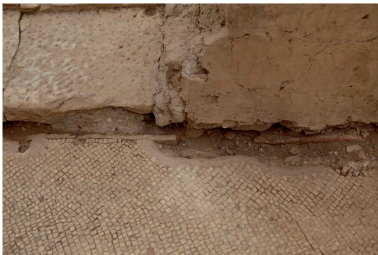
Abb. 8: Raum 32e, abgeschlagene Platte der Marmorwandverkleidung und Bodenmosaik sowie Ausrißgräbchen mit Hinterfüllmörtel an der W-Wand
