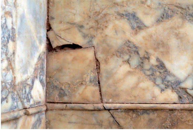
Abb. 3: Raum 38, Ausflickung in der zentralen Nische
