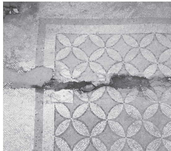
Abb. 92: Raum 38d, Mosaikboden mit Erdbebenriss
