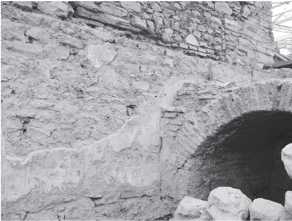
Abb. 150: 38g, O-Mauer mit Wandmalerei, die sich an 38i O-Mauer fortsetzt und an die das Gewölbe von 38g angesetzt ist
