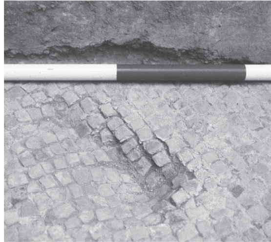
Abb. 80: Raum 38a, Schadenspuren im Mosaikboden, Detailaufnahme
