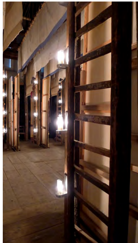
Abbildung 7. Hinter einem Kulissenflügel sind die historischen Leitern erkennbar, an denen die eisernen Halterungen mit den Kerzen hingen.
