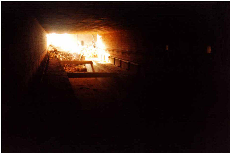
Afbeelding 11. De Loowaard ondergronds: Tunnel voor Betuwelijnroute in aanbouw (foto: Eugenie Jansen en Albert Elings).
