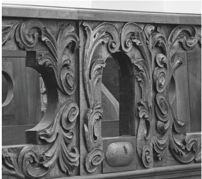
328 Kirchenbänke, Detailansicht der Brüstung. Kramsach, um 1650/60. Die Bänke waren von Anobien befallen. Bei der Restaurierung musste das weiche Blindholz, das wesentlich stärkere Schäden als das harte Nussholz aufwies, ersetzt werden. Heute kann mit Hilfe moderner Techniken auch eine stark beschädigte Holzstruktur stabilisiert und erhalten werden.
