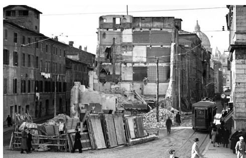
Abb. 109 Beginn der Abbrucharbeiten an der Spina zur Anlage der Via della Conciliazione, im Hintergrund der Petersdom, Jänner 1937
