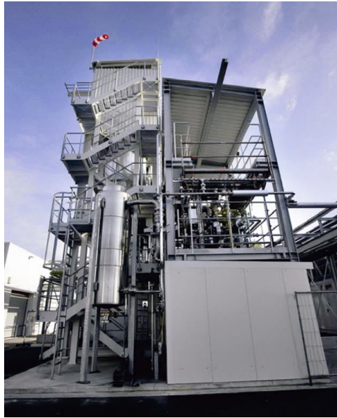
Abbildung 7-7: Methanisierungsanlage am Standort Werlte [Basshuysen 2015].
