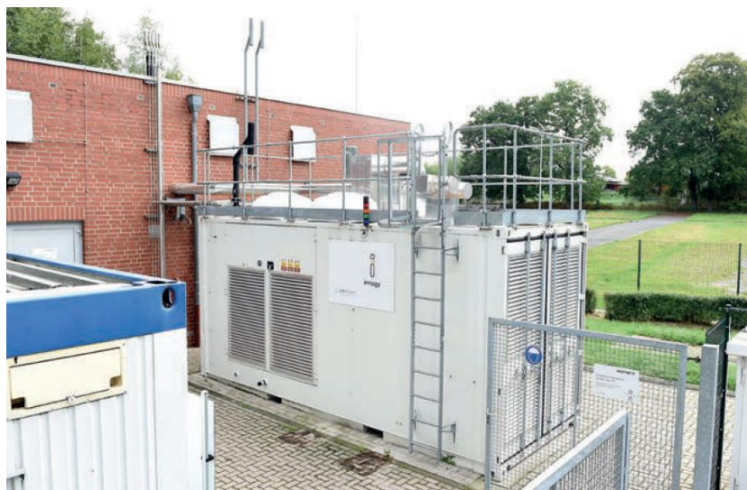
Abbildung 7-3: Elektrolyseur am Standort Ibbenbüren [Bohn 2018].
