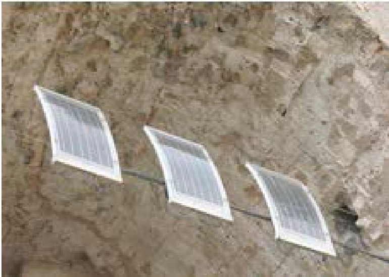
4. Portovenere (Sp), Castello Doria, particolare dei supporti curvi dei "solar flags" 4. Portovenere (Sp), Castello Doria, detail of the curved supports of the "solar flags"
