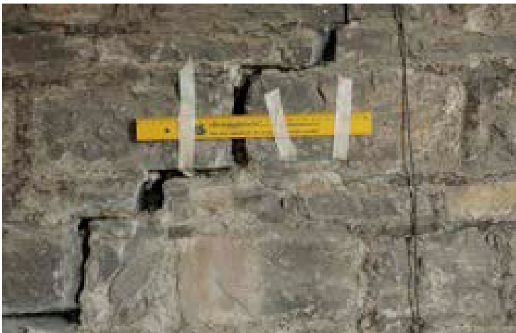
4. Firenze, Palazzo Vecchio, Lesioni prima dell'intervento 4. Florence, Palazzo Vecchio, Damage prior to the restoration
