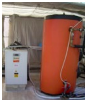
Fig. 2. Pompa di calore geotermica e boiler per l'accumulo dell'acqua calda
