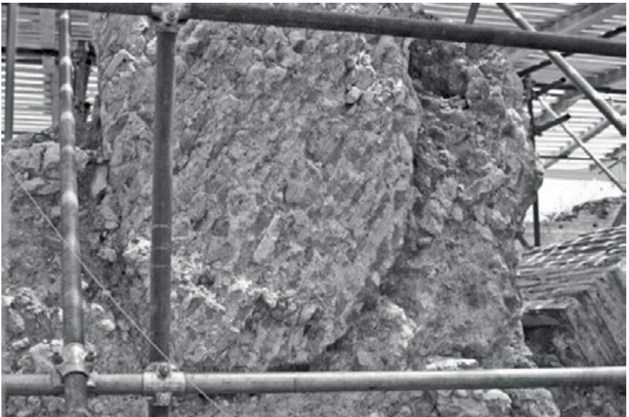
Fig. 54. Derrumbes del techo del Aula B.
