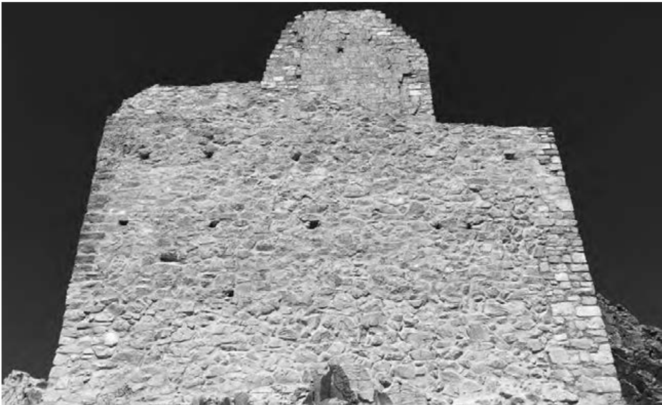
Figure 15 UT 1 - UT 2, torre e area signorile, muratura dopo il completamento dei lavori di restauro e consolidamento
