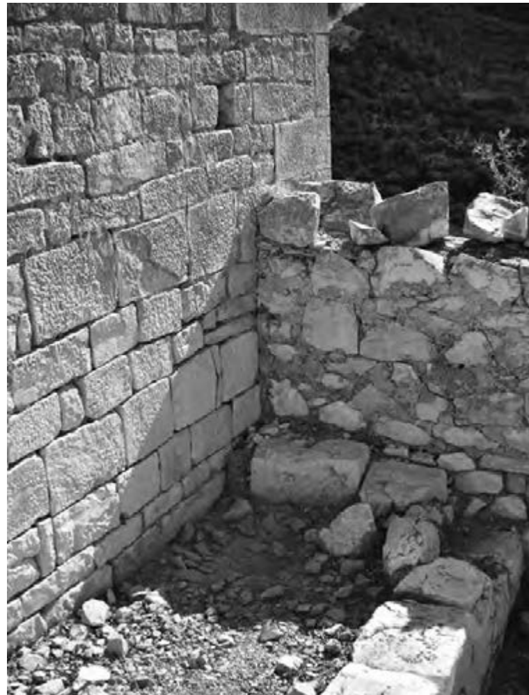
Figura 2 UT 4, chiesa, ammorsamento tra due paramenti differenti sotto il punto di vista costruttivo
