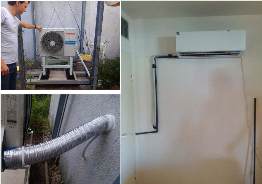
Abbildung 3 Luft/Luft-Wärmepumpe mit 3.2 kW max. Heizleistung bei der Montage im Passivhaus Darmstadt Kranichstein; links oben: Außeneinheit; links unten: Hochgedämmte Kältemittelleitungen; rechts: Inneneinheit.
