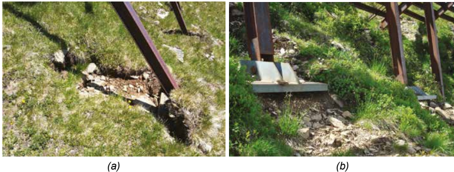
Bild 3, (a) Ausgleiten der Stützen infolge Überlastung, (b) Fortschreitende Erosion im Bereich Stützenplatten
