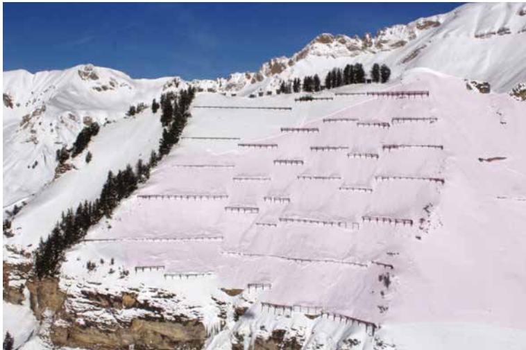
Bild 2, Stützverbauung Urseren, Brienz (BE), in der Lawinenperiode vom 21./22. Januar 2018 brach in der Verbauung grossflächig eine Schneebrettlawine an. Die Anrisshöhe betrug rund 50 cm. Die Bruchausbreitung wurde durch die Werkreihen nicht gestoppt. Beim Aufprall auf die Werkreihen wurden die Schneemassen abgebremst und teilweise gestoppt. Die Lawine verursachte keine Schäden (Foto: U. Ryter).
