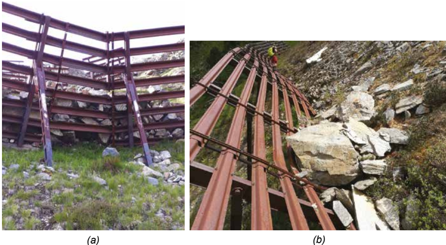
Bild 4, (a) Steinschlag nach Auftauen der Permafrostböden, (b) Steinschlagschaden in der Stützverbauung
