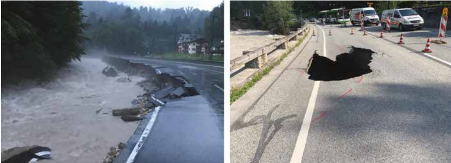
Abb. 2: Zerstörte Stützmauer Bahnhofsvorplatz Berchtesgaden (links) und unterspülte Stützkonstruktion am Durchlassbauwerk bei Gartenau (rechts).
