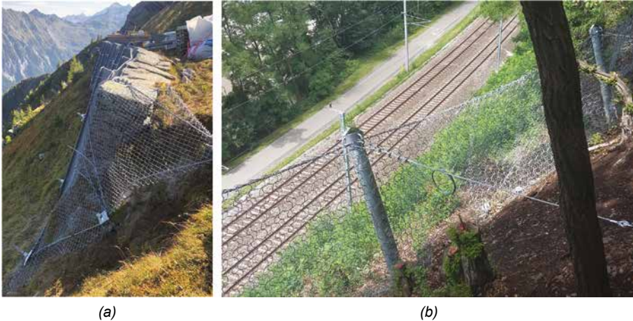
Bild 5, (a) saniertes Bauwerk der Phase 2 (Lawinenmauer mit vorgesetzter Netzankerwand), (b) saniertes Bauwerk der Phase 3 (Drahtseilsperrre umgerüstet zu 300 kJ-Steinschlagschutznetz)
