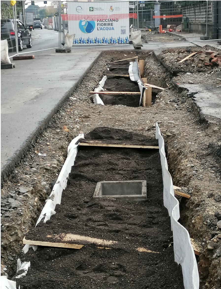
Fig. 2 – Cantiere di via Matteotti in Bovisio Masciago: dettaglio scavi di un rain garden e medium di riempimento (febbraio 2023)
