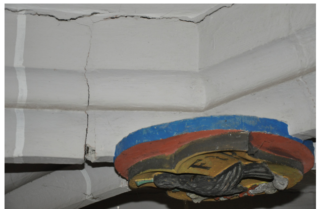
1.4 Abriss der Rippen von der Gewölbeschale; in der Zugzone der Rippen aufgehender Riss in der Stoßfuge zweier Werksteine
