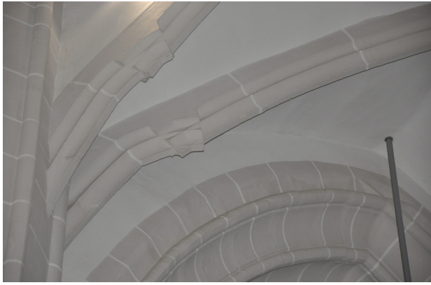
Abb. 3.37 Eingesetzter, zum Ausgleich der fehlenden Diagonallänge des Jochs bestimmter Rippenwerkstein der Rippe 5 im Joch 3
