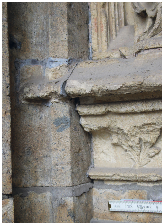
11 Köln, Hohe Domkirche Sankt Petrus, Westfassade, Petersportal, Übergänge zwischen den Werksteinen des Tympanons und der Architekturprofile, nördliche Seite.
