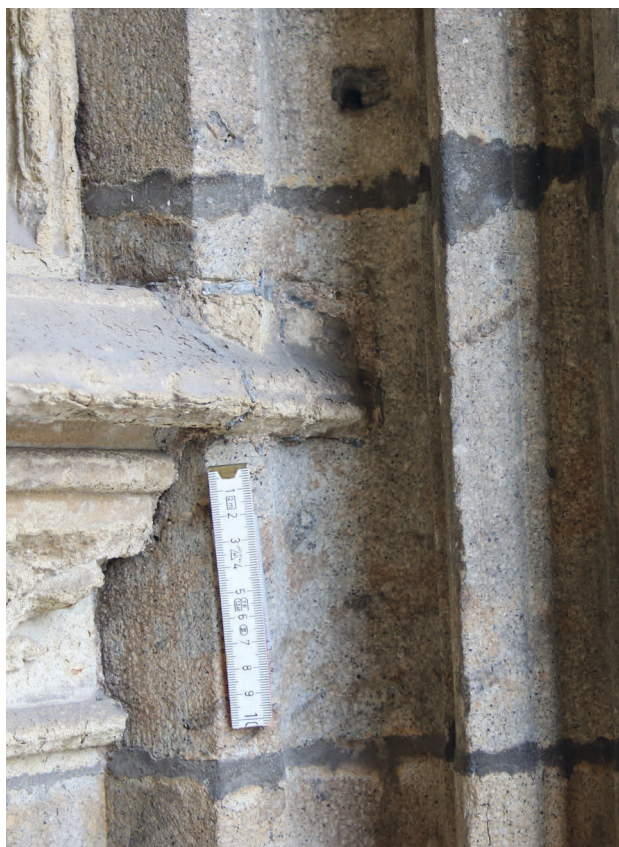
10 Köln, Hohe Domkirche Sankt Petrus, Westfassade, Petersportal, Übergänge zwischen den Werksteinen des Tympanons und der Architekturprofile, südliche Seite.
