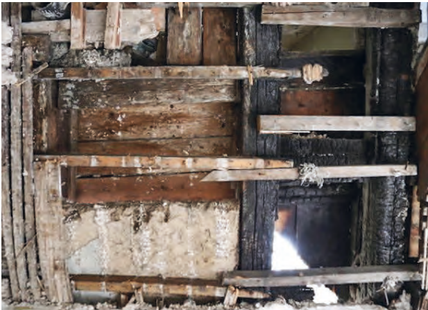
Abb. 1: Deckenkonstruktion eines Altbaus mit Brandschaden [Schalk 2020].
