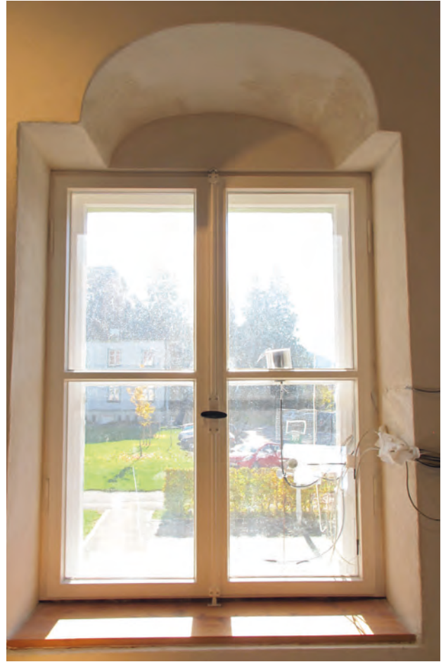
Abb. 5: Energetisch ertüchtigtes Fenster in der Alten Schäferei, Benediktbeuern, mit Messaufbau [Fraunhofer IBP 2019].
