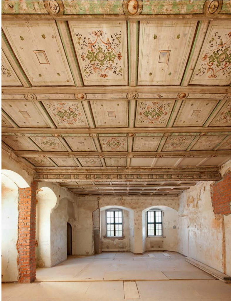
Abbildung 53. Colditz, Schloss Colditz, Kellerhaus, erstes Obergeschoss, ehem. K 1.2–K1.3, zusammengefasst zu K 1.2 nach neuer Zählung, Holzdecke um 1583/84, Ansicht von Osten
