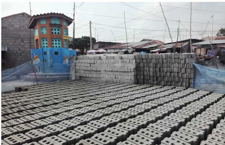
STOCKS POUR LE FUTUR CHANTIER, LADJI, 2018 (@ACML).
