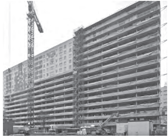
CHANTIER «GRAND PARC» À BORDEAUX, PAR LACATON & VASSAL ARCHITECTES, FRÉDÉRIC DRUOT ARCHITECTURE, CHRISTOPHE HUTIN ARCHITECTURE (2015). SOURCE: PHOTOGRAPHIE PHILIPPE RUAULT.
