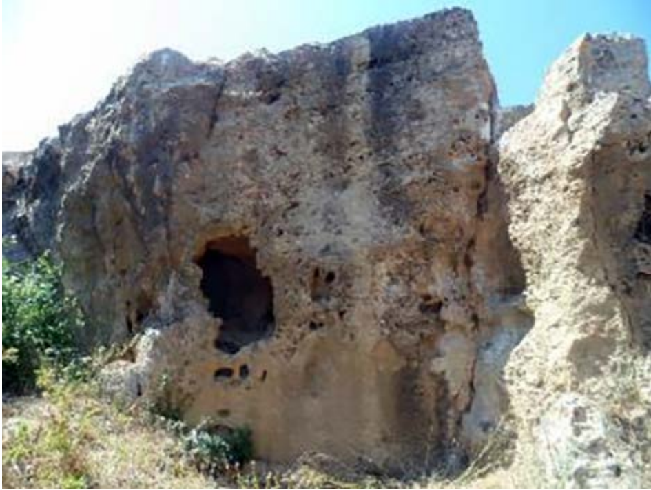
Εικόνα 5. Κυψελοειδής φθορά λόγω ανέμων οι οποίοι μεταφέρουν σταγονίδια με υψηλή περιεκτικότητα σε άλατα Λατομείο 4
