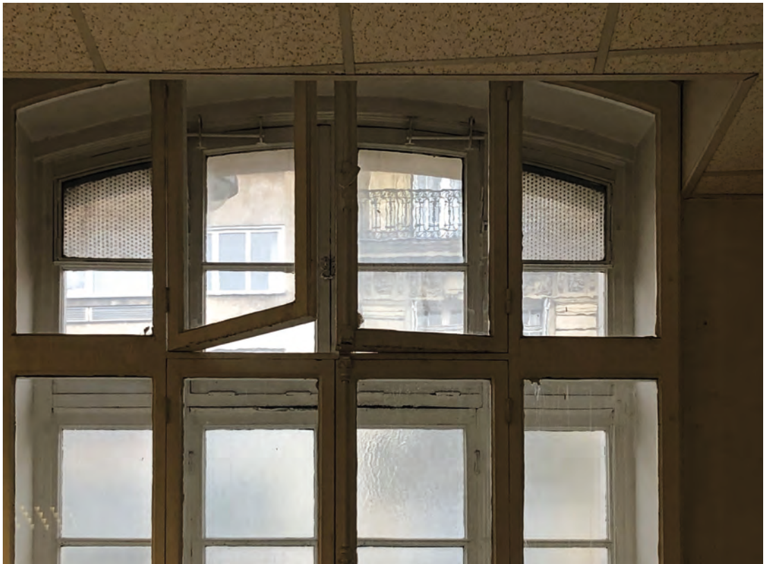
7 Carreau en verre perforé, placé en imposte dans une salle de classe du lycée Janson de Sailly, Paris.
