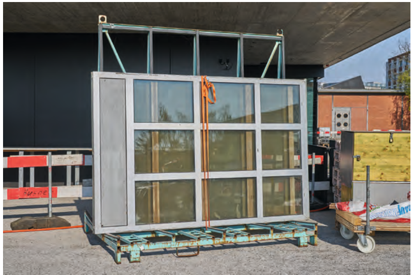
8 Unit Sprint, NEST Dübendorf, 2021, baubüro in situ ag, Basel, Wiederver- wendung und Ertüchtigung bestehender Fenster und ihrer Gläser.
