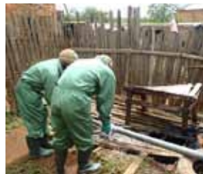
Nettoyage de la pompe Gulper.
