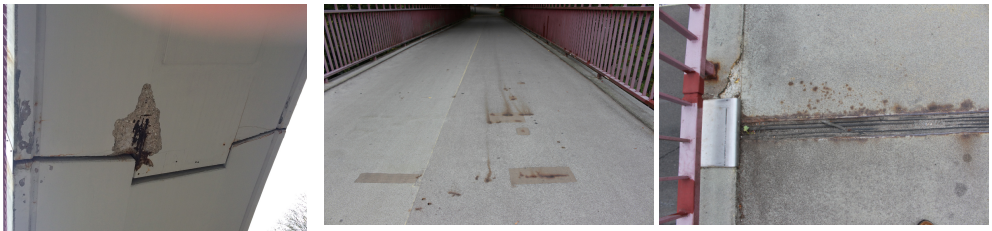
Abbildung 6.5: RWA-Brücke: Korrosionsschaden an der östlichen Auflagerkonsole (links), im Stützbereich des östlichen Randfeldes (mitte) und im Bereich der Übergangskonstruktion (rechts) [56]
