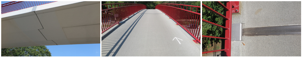
Abbildung 6.6: RWA-Brücke: Sanierte östliche Auflagerkonsole (links), Stützbereich des Randfeldes nach Sanierung (mitte) und neue Übergangskonstruktion am östlichen Ende der Einhängeplatte (rechts) [56]
