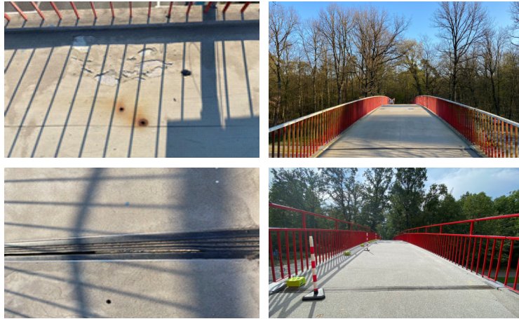
Abbildung 6.8: LA-Brücke: Korrosionsfahnen und beschädigte Beschichtung (links oben), beschädigte Übergangskonstruktion an der nördlichen Auflagerkonsole der Einhängeplatte (links unten), Geländer vor der Ertüchtigungsmaßnahme (rechts oben) und erhöhtes Geländer nach der Ertüchtigungsmaßnahme (rechts unten)
