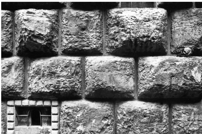
Fig. 44. Palazzo Medici, dettaglio del paramento basamentale su via Cavour (bugne J).
