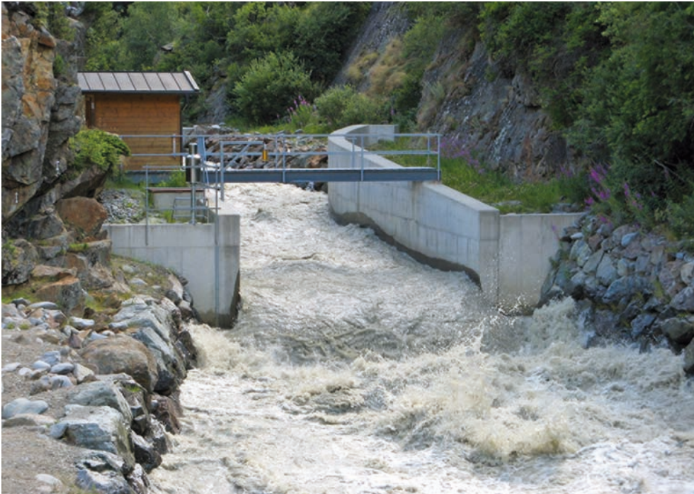
Abb. 4: Die Pegelanlage Vent/Rofenache im Jahre 2005 mit begehbarem Pegelhäuschen, Messsteg und betoniertem Gerinne mit Einlauftrompete im Oberwasser. Gemessen werden: Wasserstand (RADAR und Drucksonde), Oberflächengeschwindigkeit des Wassers (RADAR), Wassertemperatur, Schwebstoff (Trübungssonde), Geschiebe (Geophone in der Gewässersohle). Sämtliche Parameter werden kontinuierlich gemessen, vor Ort digital aufgezeichnet und mittels GPRS fernübertragen (Foto: Hydrographischer Dienst Tirol)
